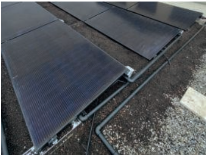
Private Schwimmbadheizung, Schweiz
