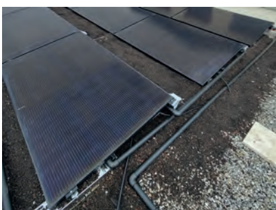
Private Schwimmbadheizung, Schweiz
