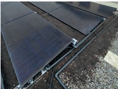
Private Schwimmbadheizung, Schweiz
