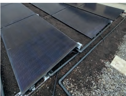
Private Schwimmbadheizung, Schweiz
